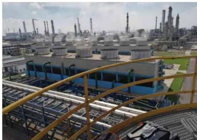
开式循环冷却水塔，应定期检测并开展泄漏检测与修复
