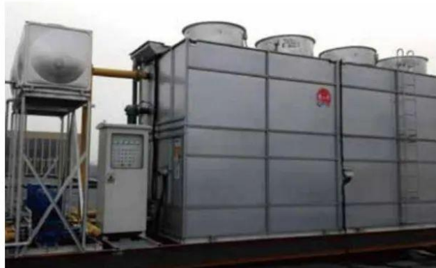
闭式循环冷却水塔，循环水不与外界直接接触
