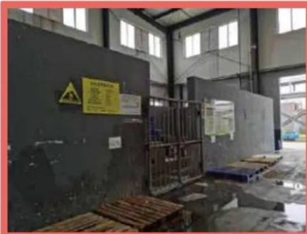
✘ 危废间未密闭，无收集系统
